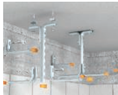
TP-süsteemi tervikmontaaž Peatugevdusega TP-riputusprofiili ja kanduri mõlemapoolne paigaldamine ning paigaldamine otse seinale.
