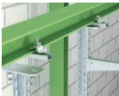
C-profiiliga terasklamber, pikisuunaline trass U-ripitusprofiili monteerimine, kinnitatud teraskandurile C-profiili CPS 4 G ja kerge pingutussõra TKH-L-25 abil. Trassi kulgemine piki teraskandurit.
