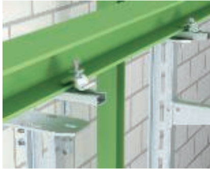
C-profiiliga terasklamber, pikisuunaline trass I-ripusprofiili monteerimine, kinnitatud teraskandurile C-profiili ja pingutussõra TKH-L-25 abil. Trassi kulgemine piki teraskandurit.
